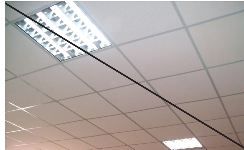
Плохо Открытые направляющие
